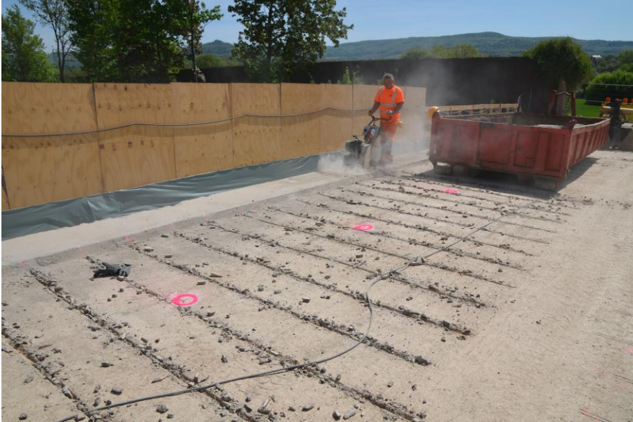
Brückeninstandsetzung einer Autobahnbrücke auf der BAB A70 Verstärkung des Kragarmes durch nachträgliche Bewehrung
